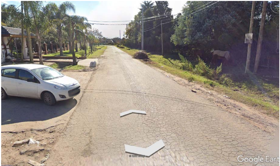
Imagen 4. Deterioro en Camino Secundario N° 070-08. Partido de La Matanza
